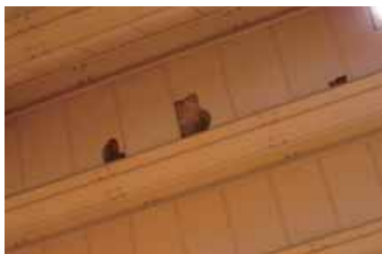
体育館アリーナ 天井ボードの破損状況
