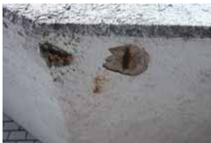
外部階段裏 コンクリート爆裂状況
